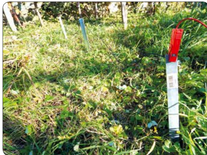
Ustrezna ozemljujev je predpogoj za učinkovito delovanje elektromreže. (Foto: Tomaž Berce)
